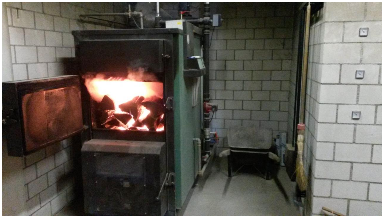
Stückholzheizung der Familie Christoph & Therese Villiger, Luegetenhof in Auw ausgezeichnet mit dem Holzenergiepreis als innovative und vorbildliche Energieholznutzung
